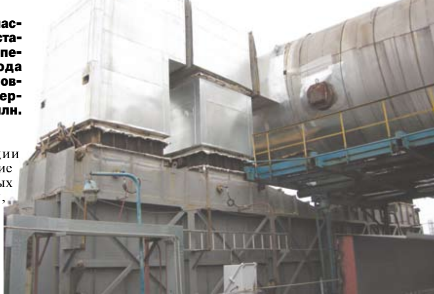
Дополнительная конвективная секция печи П-1
